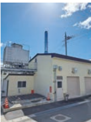
役場のバイオマスボイラー
