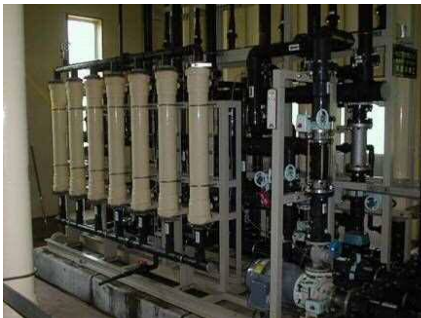
クリプトスポリジウム対策に優れた効果のある有笠浄水場の膜ろ過設備
