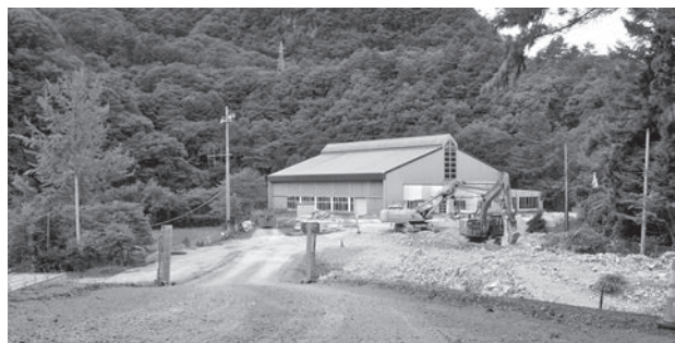
診療所の新築に向け、旧入山小の校舎等を解体しました。
