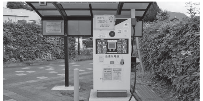
ふるさと交流センターつむじの急速充電設備
