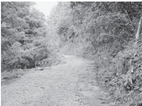
災害により路肩が崩落した万沢線 このような箇所の修繕を行います
