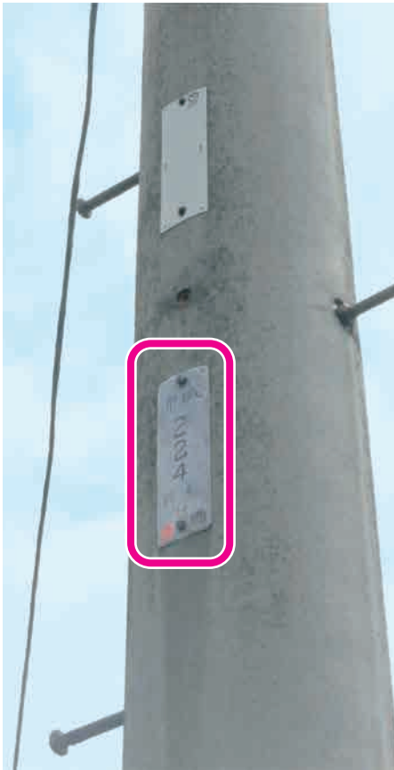
電柱の管理番号
